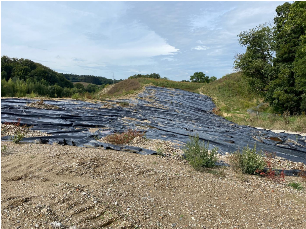
Ansicht auf den bereits verfüllten Deponiebereich, auf dem eine Photovoltaikanlage errichtet werden soll. Im Bildhintergrund wurde die Deponie bereits mit bindigem Boden abgedeckt. Der Bereich im Bildvordergrund wurde bis zur Andeckung mit Boden mit Folien abgedeckt..
